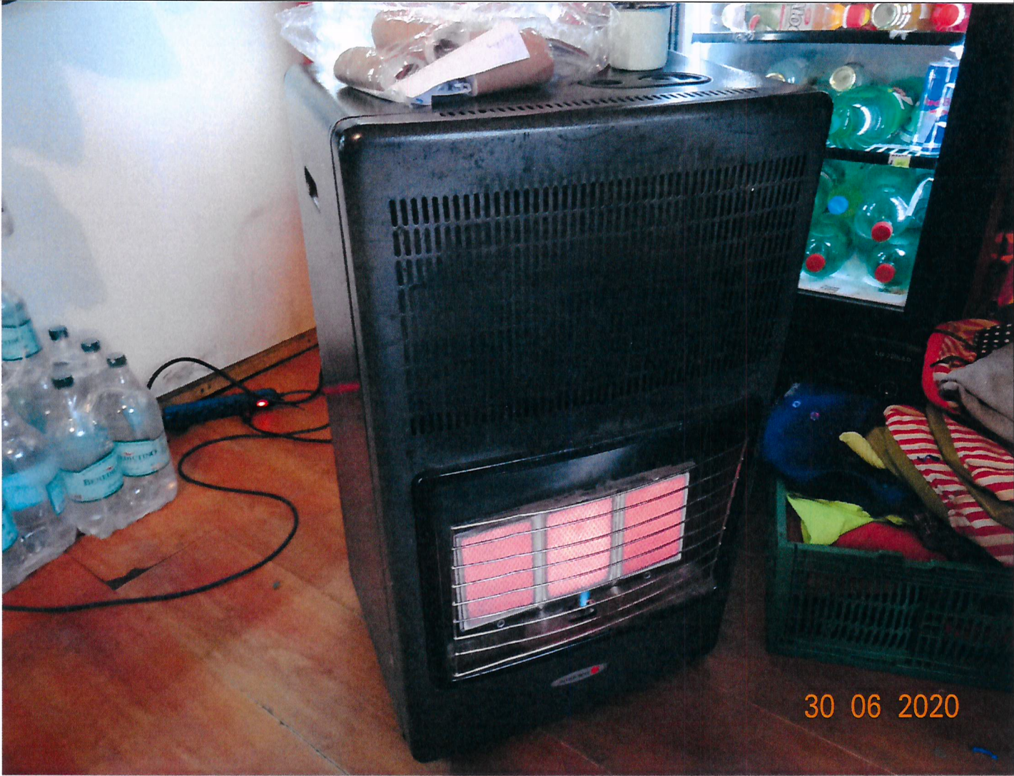
Descripción del medio de prueba: En el local comercial existe un calefactor a gas encendido.
