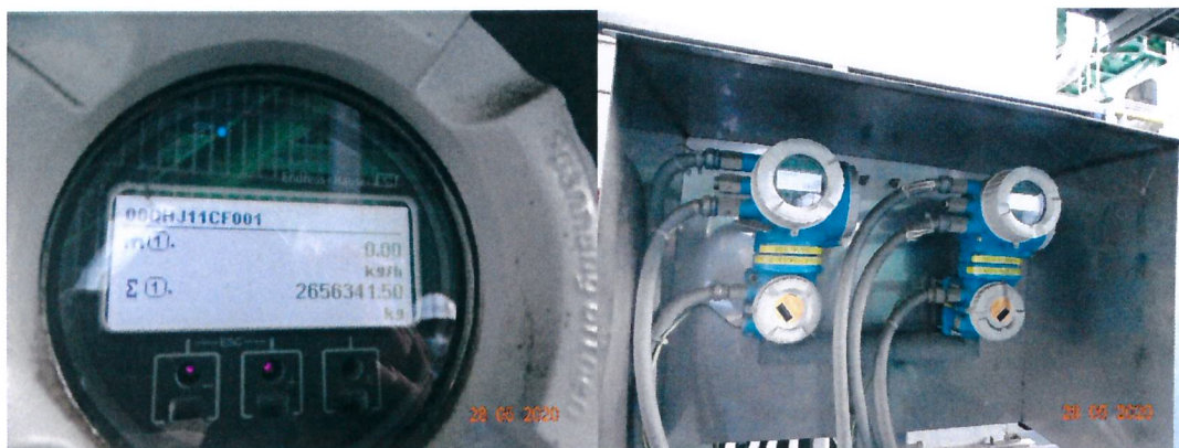
Fotografía 5: Flujómetro de combustible caldera auxiliar.
