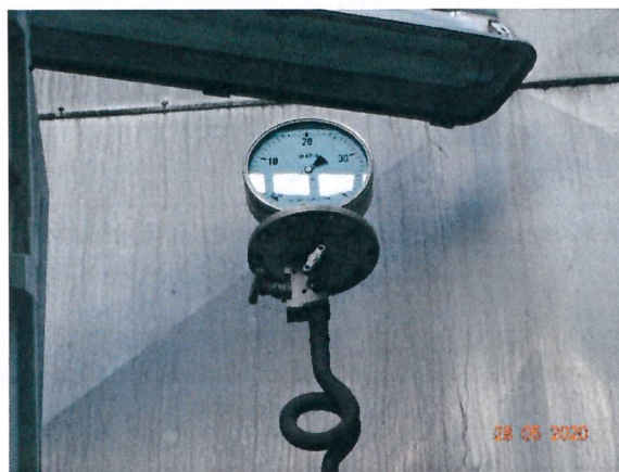
Fotografía 6: manómetro de la caldera auxiliar en cero, no operativa al momento de la inspección.
