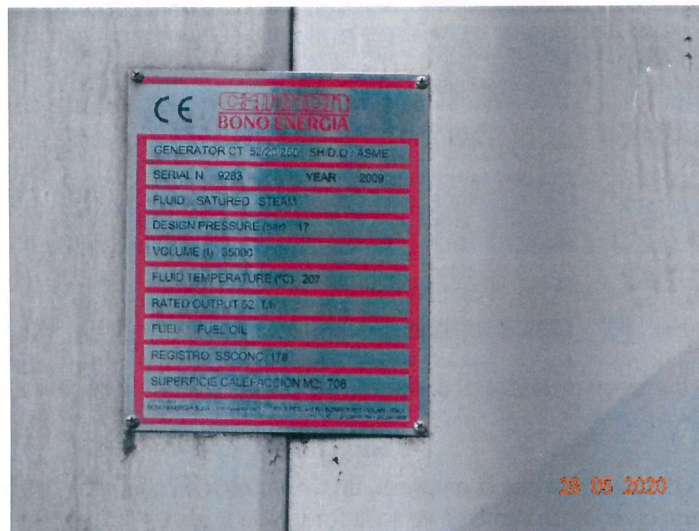
Fotografía 4: Placa caldera auxiliar.
