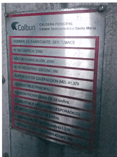
Fotografía 7: Placa caldera principal.
