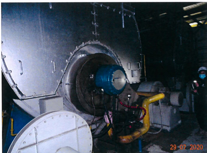
Fotografía 1: Caldera N°3 Foodcorp
