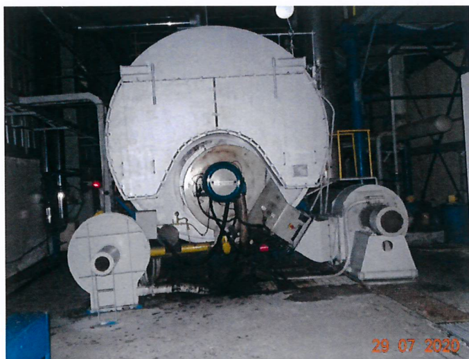
Fotografía 1: Caldera N°4 Foodcorp
