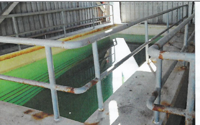
Fotografía 8. Zona de Tratamiento de Riles.
