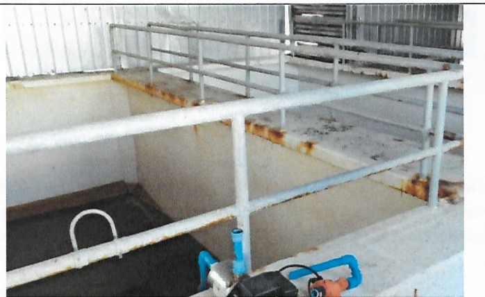
Fotografía 7. Zona de Tratamiento de Riles.
