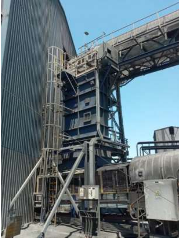
Foto 9: Colector de polvo Torre Transferencia 210
