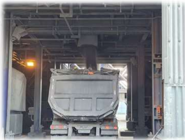
Foto 27: Descarga de residuos de combustión sobre camiones.
