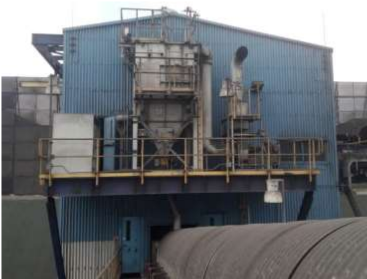
Foto 10: Colector de polvo Torre Transferencia 211
