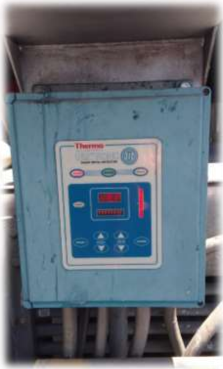
Foto 7: Panel Detector de metales
