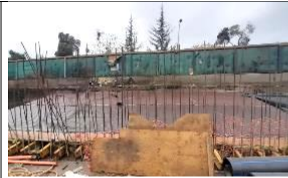
Fotografía 10 Medida acústica implementada, tapa de ducto subterráneo con paneles OSB.
