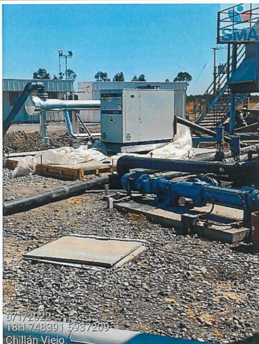
Foto N° 11. Estación N° 6 Habilitación de sistema de deshidratado y condensado de biogás.
