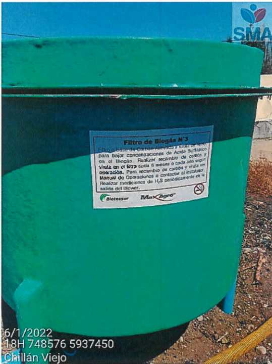
Foto N° 7. Estación N° 7 Biofiltro chimenea de quema de biogás laguna de acumulación.
