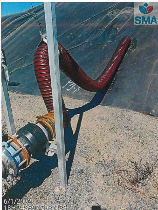
Foto N° 9. Estación N° 6 Extracción de biogás desde digestores.
