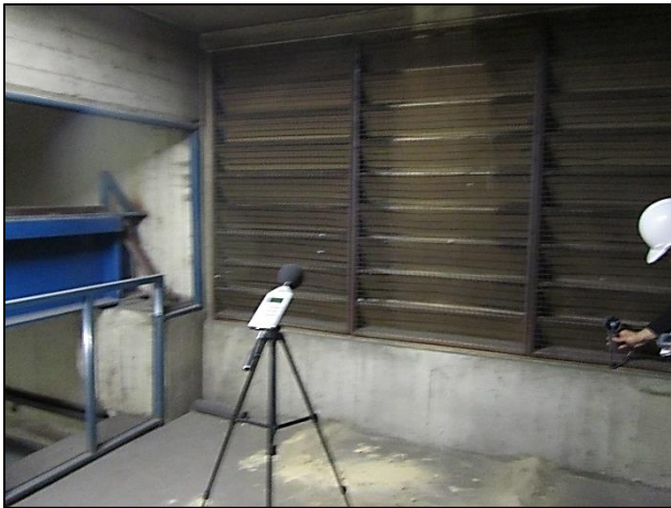
Imagen 11 – Medición en vano de descarga.
