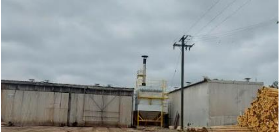
Filtro de mangas instalado en caldera SSMAU-350
