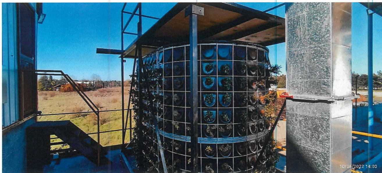
Foto 2 biofiltro del sistema de abatimiento de gases
