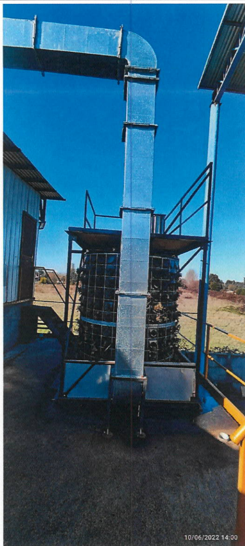
Foto 3 Ducto de salida de gases post abatimiento.
