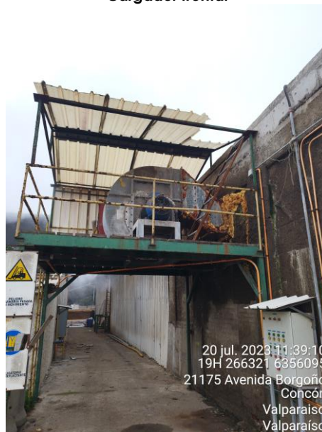
Ventiladores en operación
