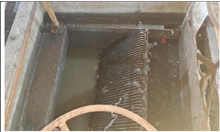
Fotografía 1. Cámara de entrada a PTAS Lota.
