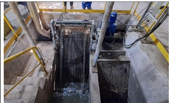
Fotografía 5. Reja automática fina PTAS Lota.
