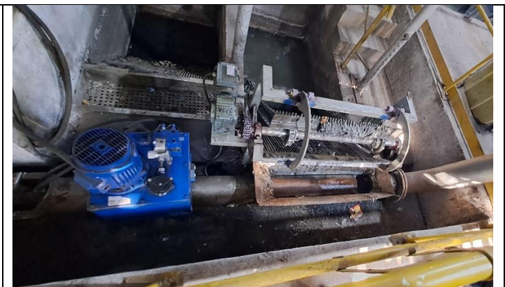
Fotografía 6. Sistema de compactación de residuos.
