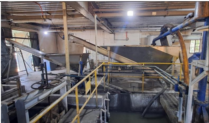
Fotografía 4. Cámara decantadora PTAS Lota.
