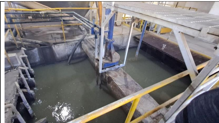
Fotografía 3. Cámara decantadora PTAS Lota.
