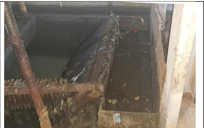
Fotografía 2. Cámara de entrada a PTAS Lota.
