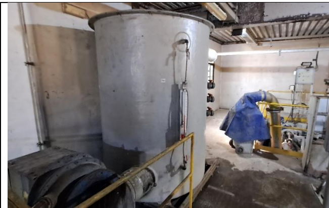
Fotografía 7. Extractor de olores PTAS Lota.
