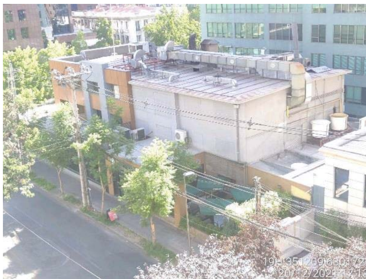
Equipos en azotea
