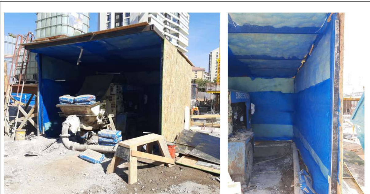
Fotografía 3: Encierro Acústico para Bomba de Hormigón
