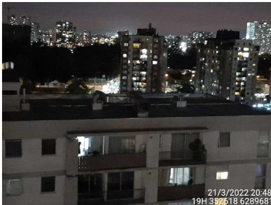
Equipos de clima en azotea
