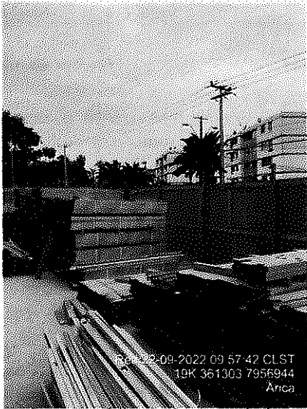
Barrera acústica sector norponiente
