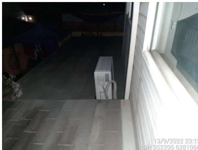
Equipo de aire acondicionado
