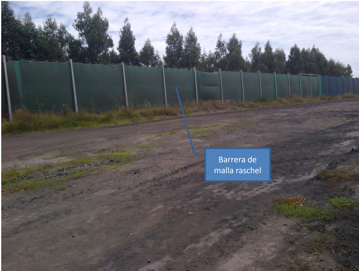
Fotografía N° (de fecha 01-02-2013)
