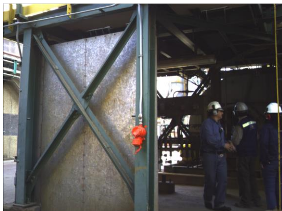
Fotografía N° (de fecha 31-01-2013)
