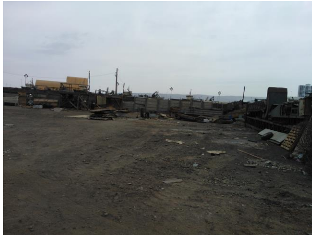
Foto 7: Sector oriental del Galpón de acopio (nótese piezas metálicas y residuos)
