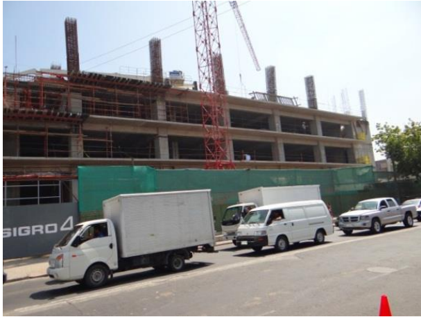
Fotografía 30: Cierre de losa de avance, no implementado en sector Sur de la obra.
