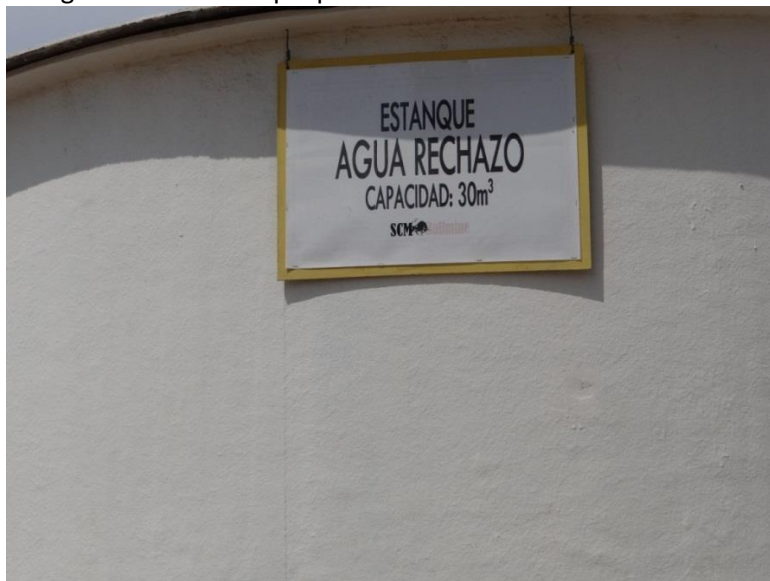
Fotografía N° 44: Estaque planta de Osmosis inversa.
