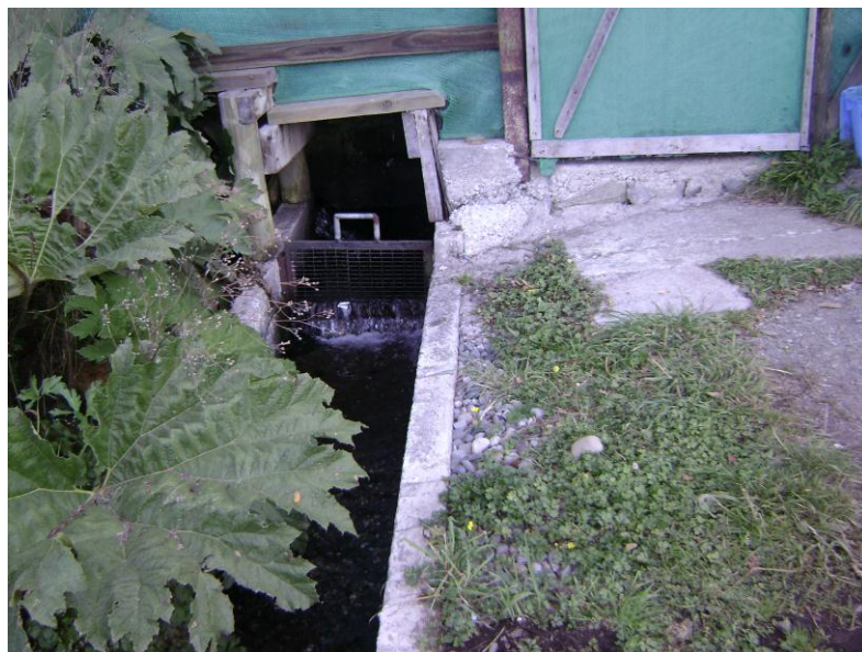
Fotografía 24. Canal que conduce aguas desde la piscicultura a su exterior.
