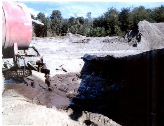
Disposición de Riles en Zanjas. Evento No autorizado en RCA.
