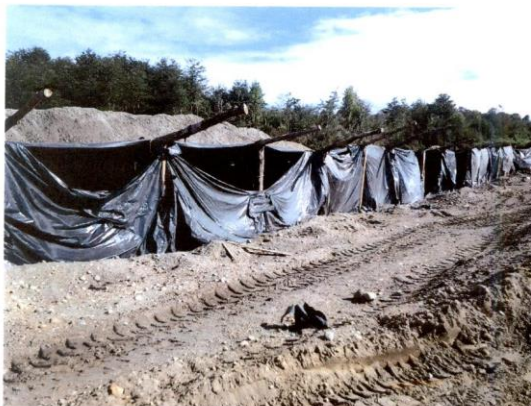
Ingreso inminente de aguas lluvias a las zanjas.
