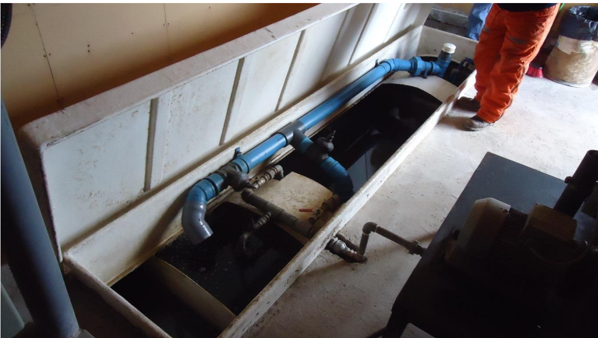
Foto 4 Detalle del estado de la PTAS inspeccionada.
