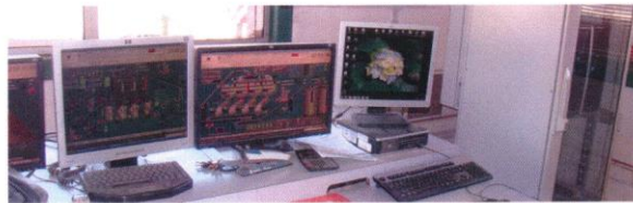
Sala de Control del Chancado de Finos. WGS 84, N 7.490.949 E. 378.505
