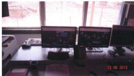
Sala de Control de Chancado Primario Propio y el de Compra.
