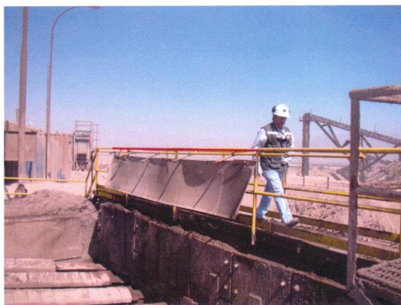
Línea de alimentación de Aspersores
