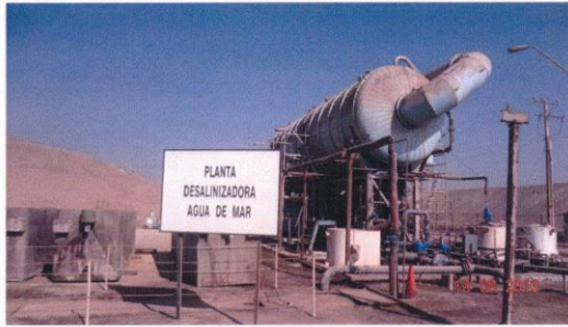
Planta Desalinizadora N° 3, WGS 84, N. 7.491.442 E. 377.876.
