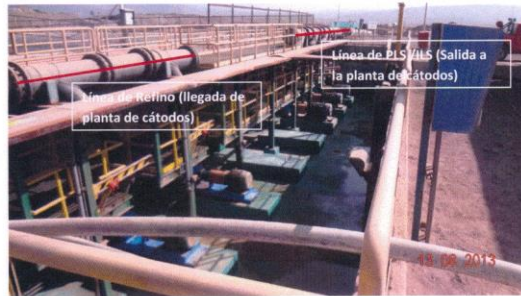
Sector de Bombas de la piscina de lixiviados del proyecto lixiviación secundaria. WGS 84, N. 7.490.777 E; 376.946.
