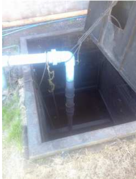
Fotografía 1 “Cámara de decantación”
