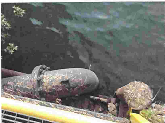
Fotografía N°1: Ducto de descarga de riles fiscalizado con fecha 15 de octubre de 2015, ubicado en ribera del río Calle-Calle, introduciéndose un metro de profundidad en el cauce.
