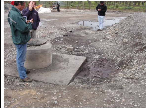
Figura N° 19: Derrame de residuos líquidos desde cámaras de inspección de riles hacia terrenos circundantes.
