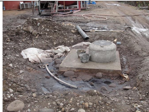
Figura N° 20: Derrame de residuos líquidos desde cámaras de inspección de riles hacia terrenos circundantes.
