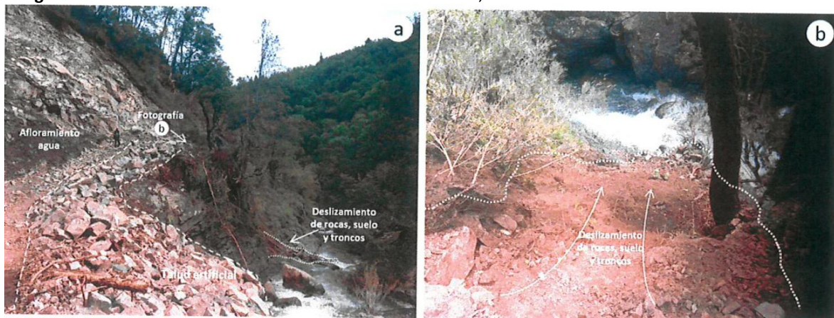
Imagen N° 16. Deslizamiento de rocas en sector de bocatoma, estero Nacimiento.
