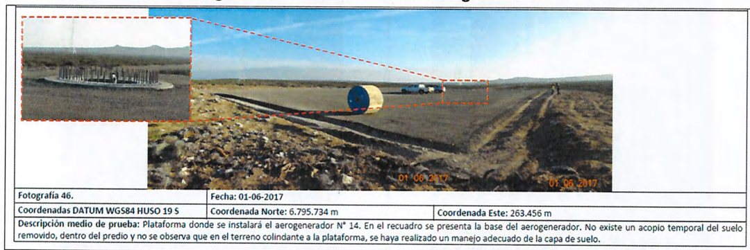
Fotografías N° 6. Plataforma del aerogenerador N° 14
