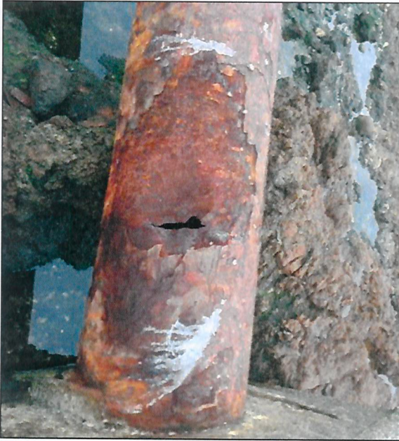
Fotografía 6: rotura del emisario.
