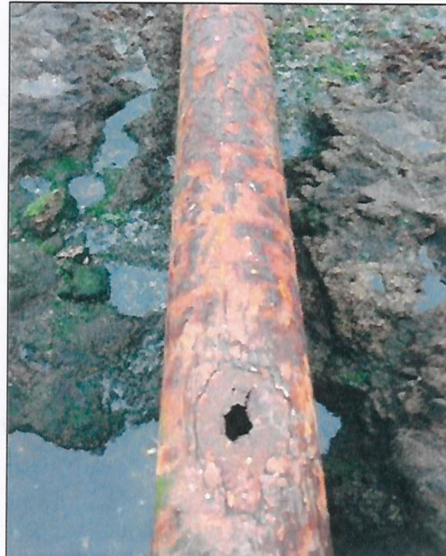
Fotografía 7: rotura del emisario.
