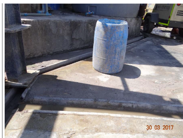
Fotografía 13. Fecha: 30-03-2017. Coordenadas UTM DATUM WGS84 HUSO 19 S. Norte: 7.518.453 Este: 510.757 Descripción del medio de prueba: Canaletas de contención de derrames, observadas entre la planta de efluentes y el galpón de insumos plomados, sin rejillas metálicas de protección.
