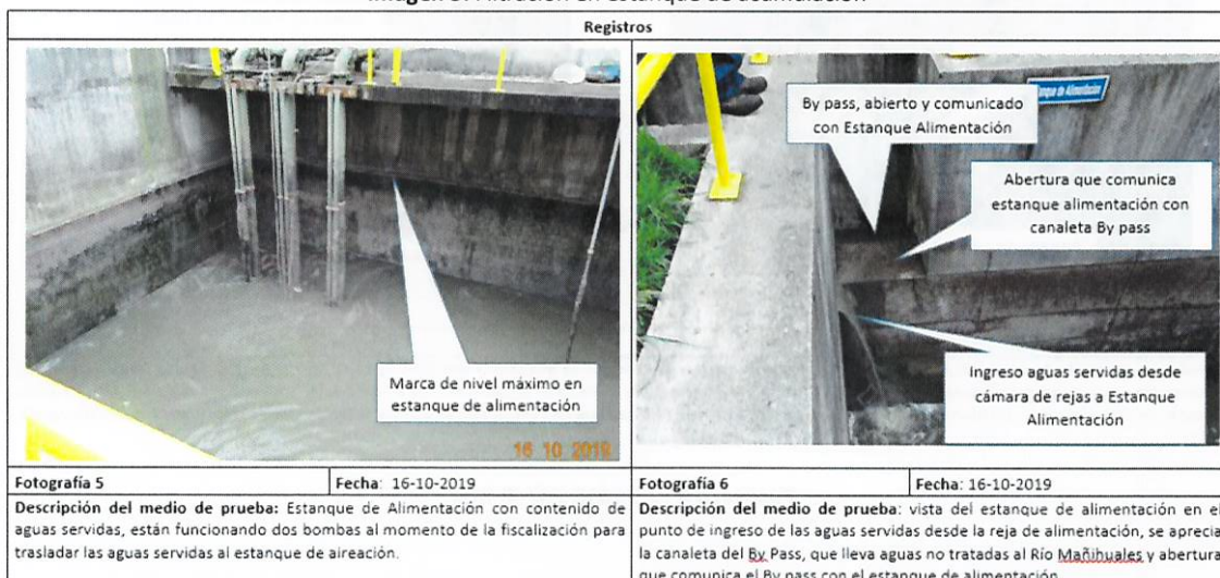
Imagen 5. Filtración en estanque de acumulación
