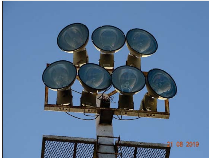
Fuente: Informe de Fiscalización DFZ-2019-2333-IV-NE, Fotografía 5.
