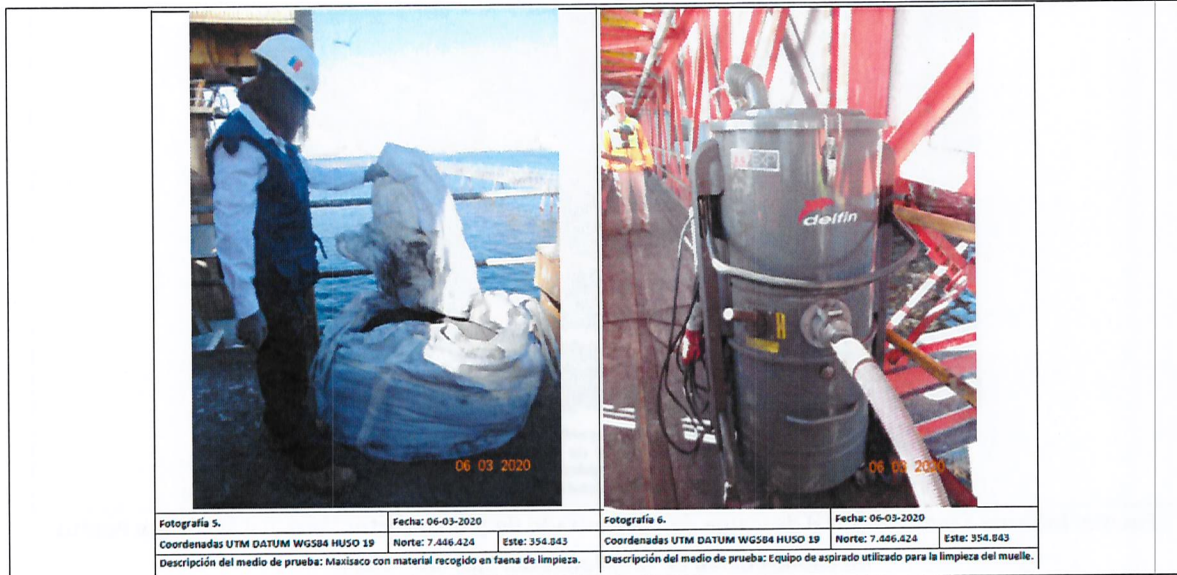
IMAGEN N° 5. EQUIPO DE ASPIRADO SOBRE EL MUELLE Y MAXISACO CON MATERIAL RECOGIDO EN LA FAENA DE LIMPIEZA
