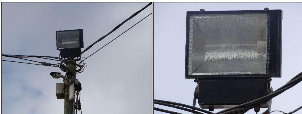
Imagen 7. Acercamiento Luminaria N° 7.
