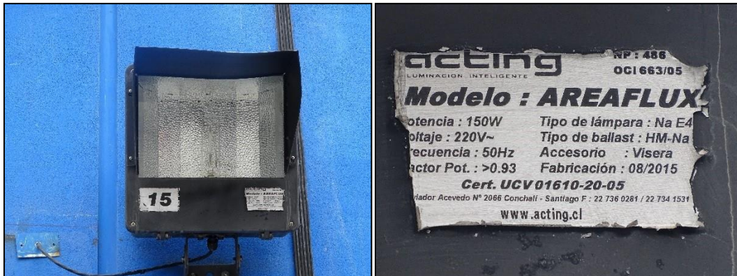
Imagen 3. Acercamiento Luminaria N° 2.
