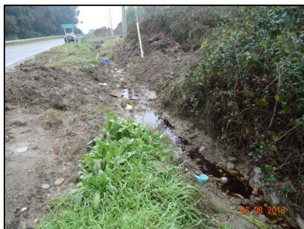
Figura N°9: canal de aguas lluvias paralelo al Vertedero Angol con contacto de residuos y lixiviados.
