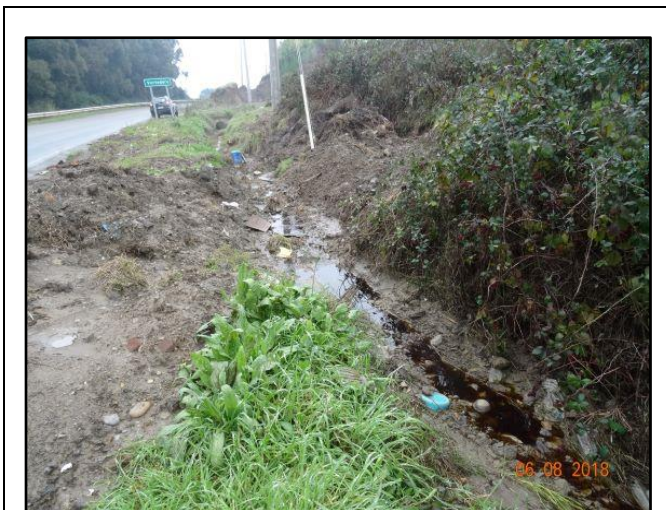
Figura N°10: canal de aguas lluvias paralelo a Vertedero Angol con contacto de residuos y lixiviados. Fuente: DFZ--2018-1523-IX-RCA, pp. 33.
