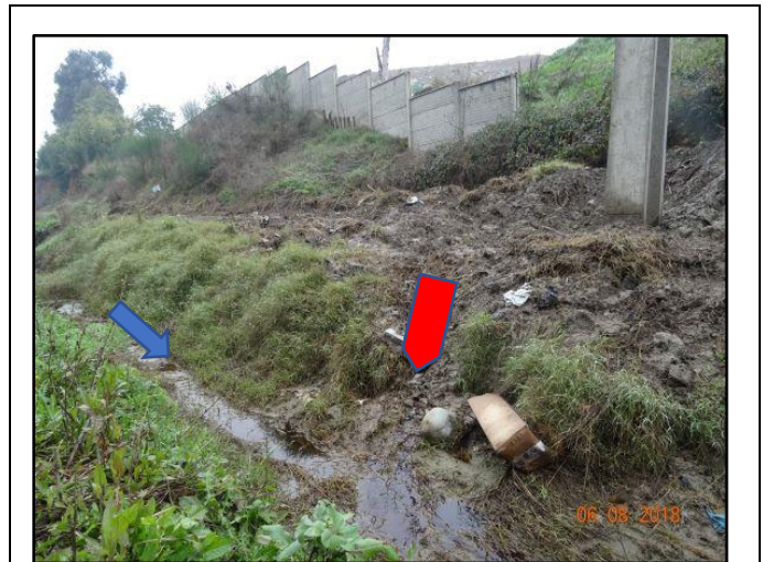
Figura N°11: descarga de líquidos lixiviados en canal de aguas lluvias paralelo a Vertedero Angol. Detrás del cerco de vibrados se ubica la piscina de lixiviados norte del Vertedero Angol. Fuente: DFZ--2018-1523-IX-RCA, pp. 39.
