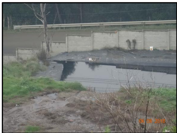
Figura N°14: rebalse de líquidos lixiviados desde piscina ubicada en sector norte del Vertedero Angol y descarga en canal de aguas lluvias. Fuente: DFZ--2018-1523-IX-RCA, pp. 44.
