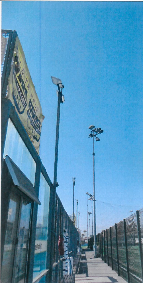
Imagen 5. Luminarias cancha de paddle (Luminaria 3).
