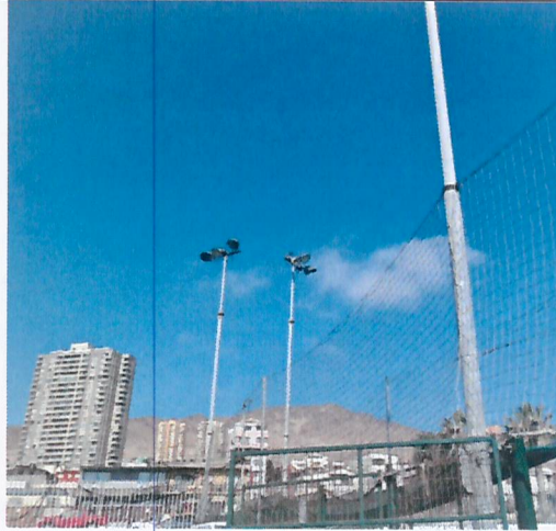
Imagen 3. Luminaria canchas de futbolito (Luminaria 2).
