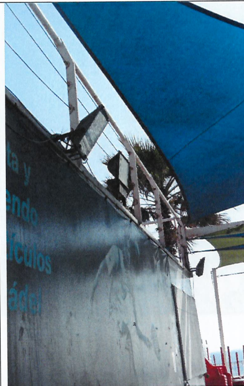
Imagen 9. Luminarias terraza (Luminaria 5).
