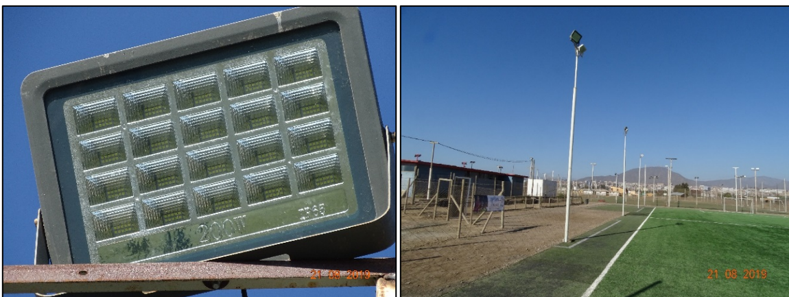
Imagen 1. Luminaria LED de 200 W con rejillas 4x5 (Luminaria 1)
