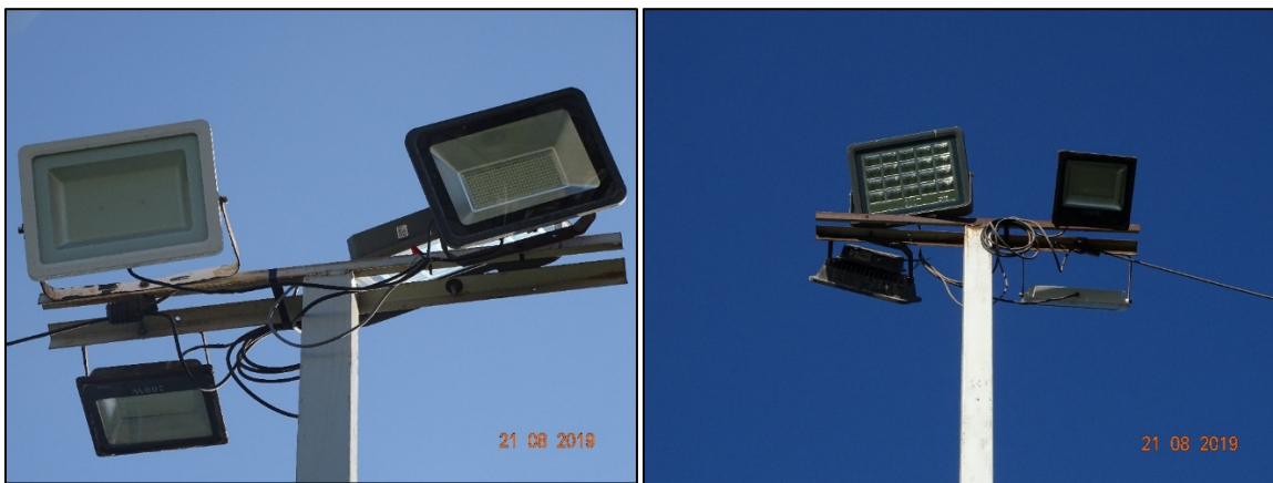
Imagen 3. Enjambre de luminarias sobre postes, sin visera ni paralumen.
