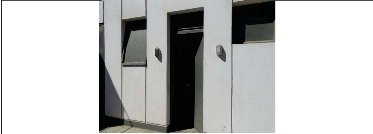
Imagen 5. Vista general luminarias ubicadas en el sector baños (Luminaria N° 2, Fotografía N° 2)
