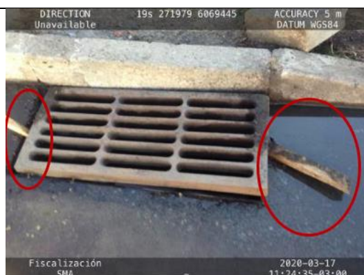
Imagen 8. Rejilla de drenaje de aguas lluvia, con maderos utilizados para facilitar la evacuación de los Riles derramados.
