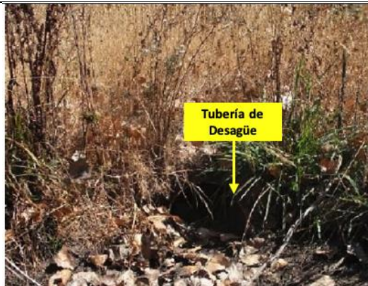
Imagen 4. Vista del desagüe constatado en la zona de riego.
