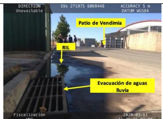
Imagen 7. Vista de la rejilla de drenaje del sistema de evacuación de aguas lluvia. Se puede apreciar la descarga de Riles desde el patio de vendimia hacia la cámara de evacuación.
