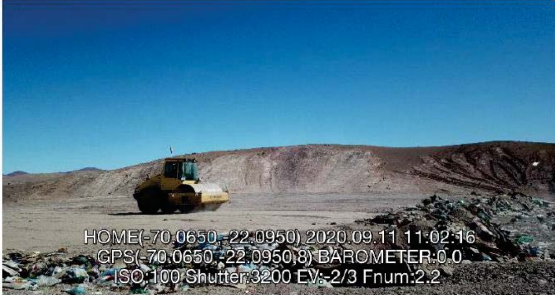
Imagen N° 4 – Residuos no compactados ni cubiertos.
