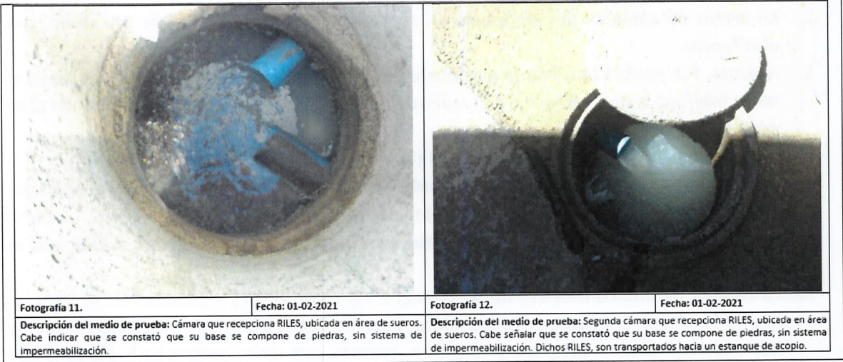
Imagen N° 01 y 02. Cámara de recepción de RILES en inspección de 01 de febrero de 2021
