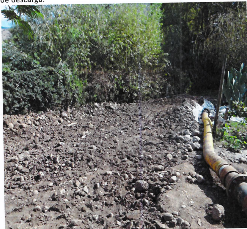
Imagen 10. Tubería amarilla que conducía aguas afloradas hacia punto de descarga.
