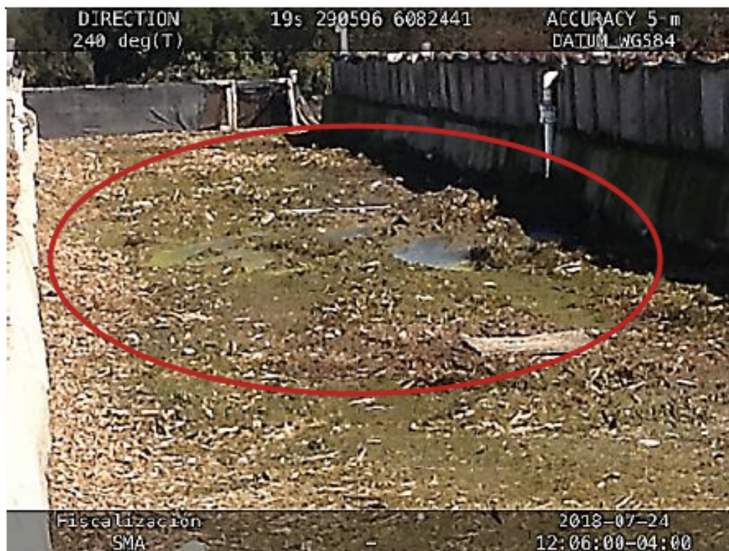
Módulos sin techo ni malla rachel, humedad y apozamiento
