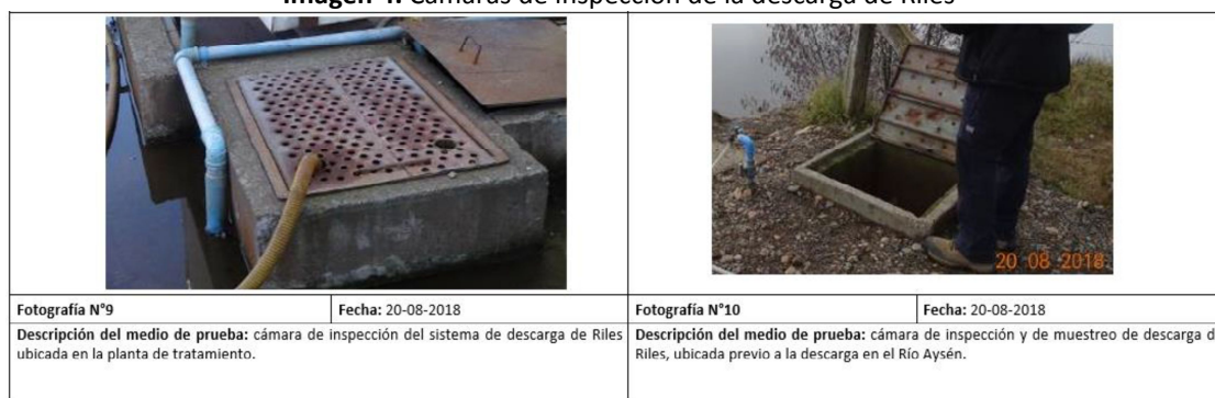
Imagen 4. Cámaras de inspección de la descarga de Riles
