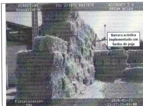
Figura 2. Barrera implementada por el titular en el sector de equipos de enfriamiento
