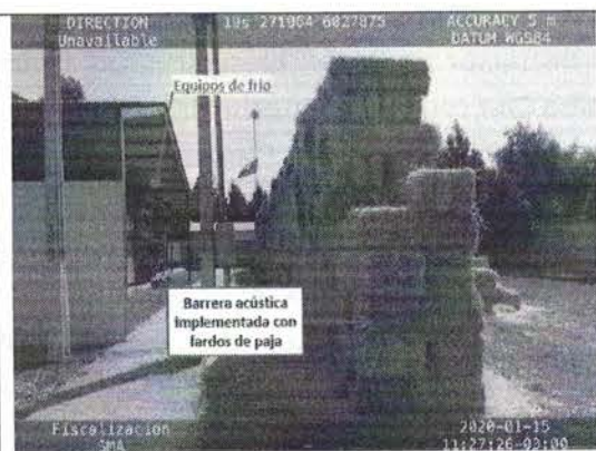
Figura 3. Barrera implementada por el titular en el sector de equipos de enfriamiento
