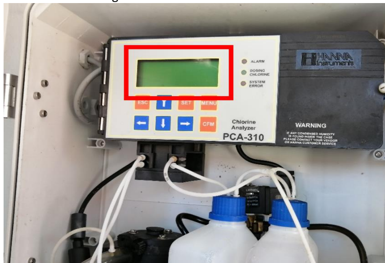
Fotografía N°10: Sistema de cloración inactivo
