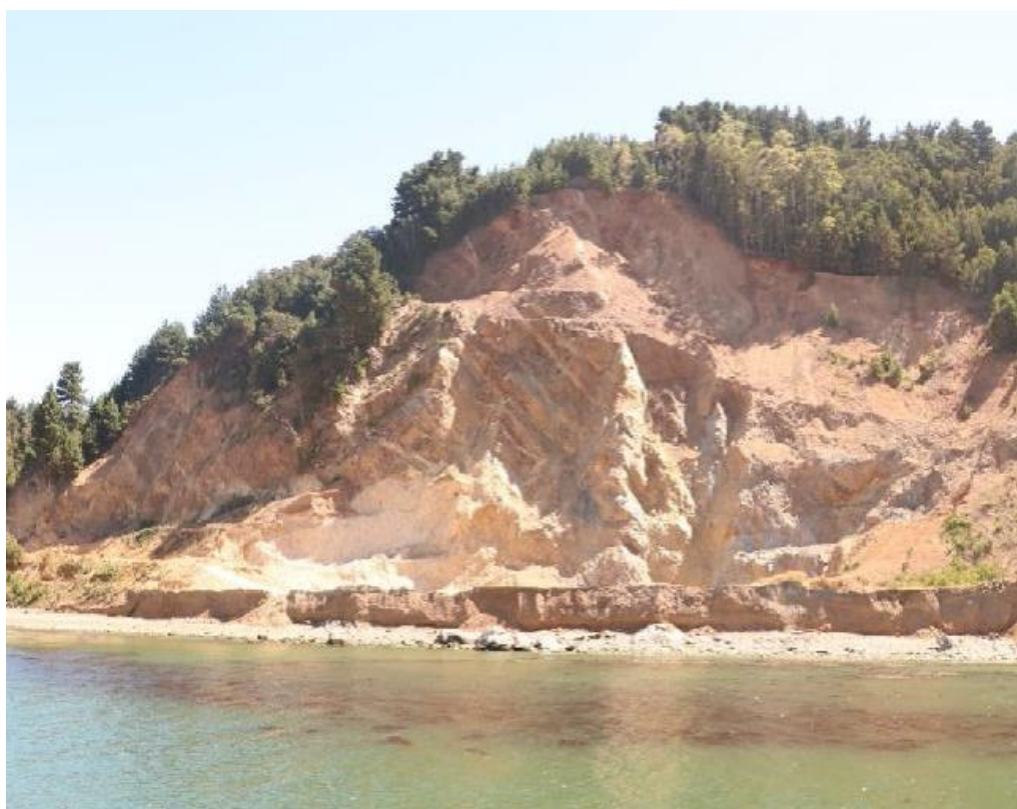
Imagen 2: Deslizamientos de material desde el terraplén con alcance en terreno de playa.
